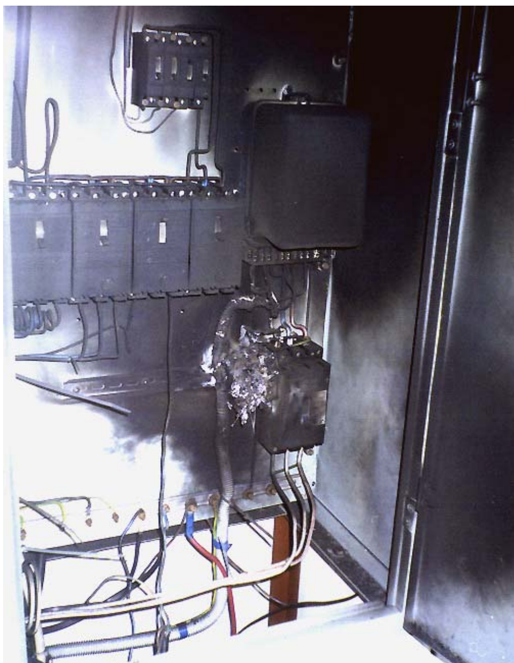
Рис.2 Выход из строя варисторного УЗИП привел к пожару в ГРЩ.
